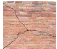
Daños en estructuras
